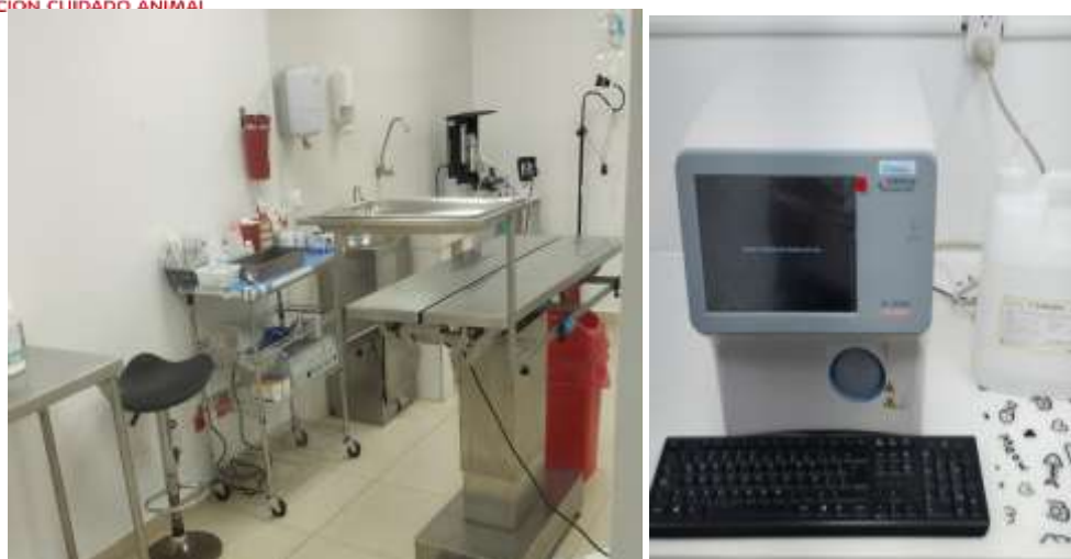
Imagen 42. Equipos de las instalaciones del CBA
